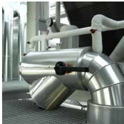
Применение в установках кондиционирования
