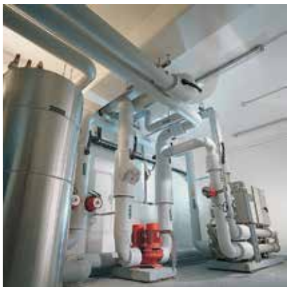
Применение в насосных агрегатах
